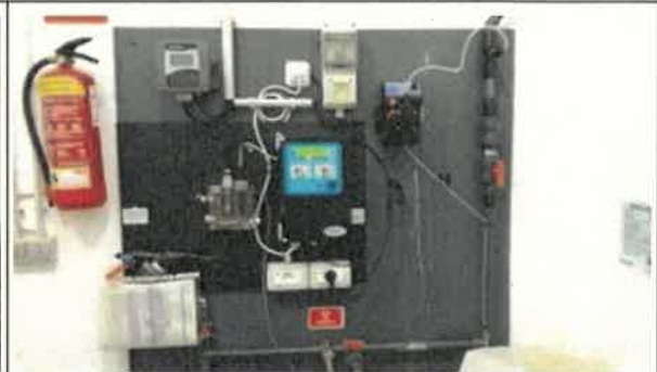
Cloración automática en Depósito
