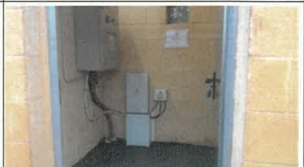
Detalle de interior de caseta de cuadro de mandos y control del pozo 1
